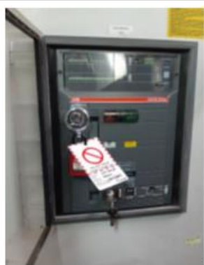
Detalle de bloqueo y consignación en apertura del interruptor automatico FG008/ Close up of lockout and tagout after isolated the stator circuitry in Circuit Breaker FG008.
