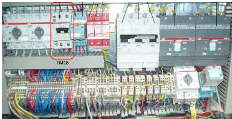
Identificación del térmico/Circuit breaker identify
